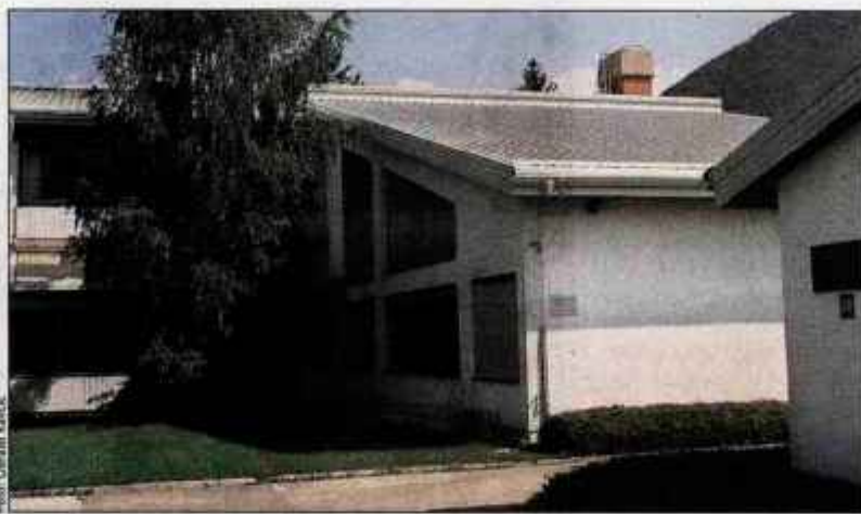
Na OŠ Križe so že prenovili streho nad avlo in dva nadstreška, načrtujejo pa še postavitev male fotonapetostne elektrarne za pridobivanje električne energije iz sončne energije.
