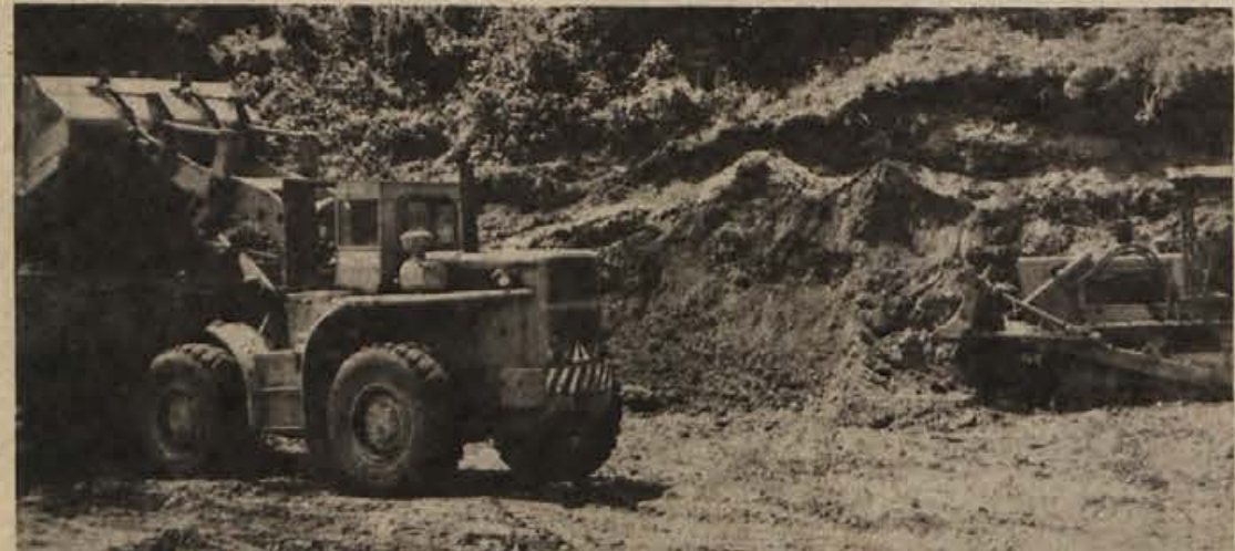
Buldozer rije v hrib za Tehniško srednjo šolo v Krškem in pripravlja teren za novo igrišče. Urediti ga nameravajo tako, da bodo na njem lahko organizirali tudi večja tekmovanja. To igrišče bo Krčanom nadomestilo izgubljeni športni prostor v Celulozi, kjer zdaj gradijo novo tovarno. (Foto: J. Teppey)
