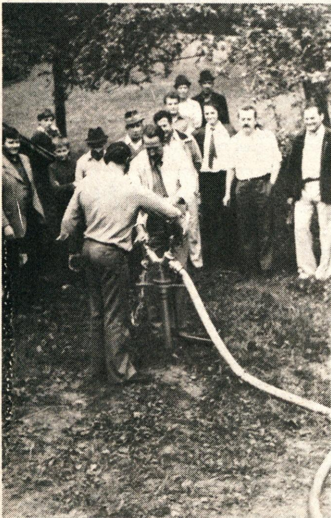
V Trobelnem so na hidrantu preizkusili, kako teče voda po novo napeljanih vodovodnih ceveh
