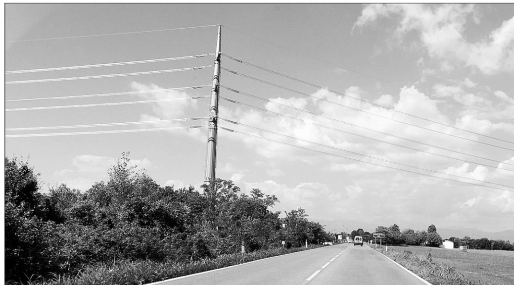
Un'immagine dei piloni di Terna nei pressi di Mortegliano: fanno parte dell'Udine - Redipuglia e sono stati installati prima che l'opera venisse definitivamente bocciata dal Consiglio di Stato
