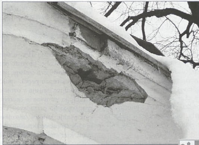
Kapelica je resnično v zelo slabem stanju
