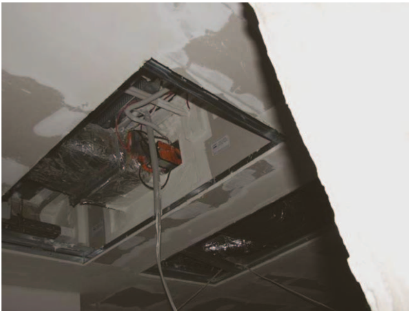
Vgrajena požarna loputa v meji požarnega sektorja nad spuščnim stropom
