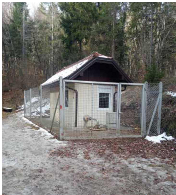
Menjava črpalke v vrtini 3 za črpanje pitne vode v Zapotoku zaradi okvare
