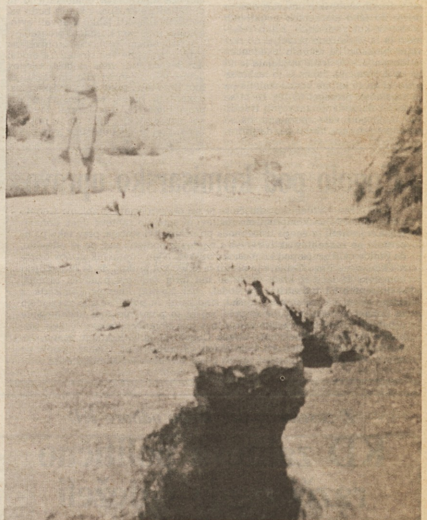
Zemlja v japonskem mestu Itu se je ta teden stresla približno 300-krat, posledica potresov pa je ta dobrih 10 cm široka in 25 metrov dolga razpoka na cesti (AP)
