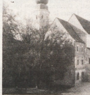
ZVONIK POSTRANI - Zaradi preperlega ostrešja je zvonik postrani in potreben obnove. Investicija bo po predračunu stala okoli 12 milijonov tolarjev.
