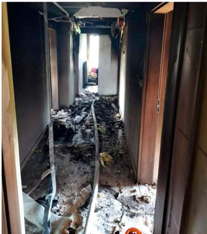
Požar je družini Bedrač povzročil veliko škodo. Zgornja etaža s streho vred je v celoti uničena. Foto: arhiv PGD Tržec
