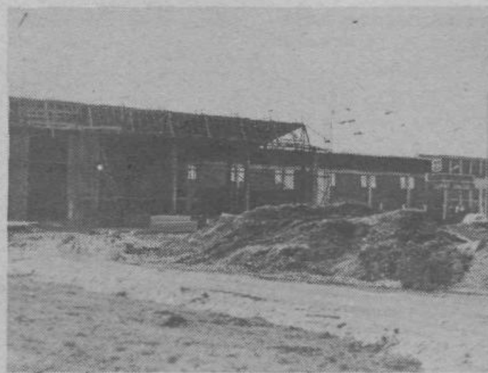
Obrat Saturnusa v Zalogu bo v kratkem dobil novo proizvodno dvorano. Večina konstrukcijskih del je že opravljena.
