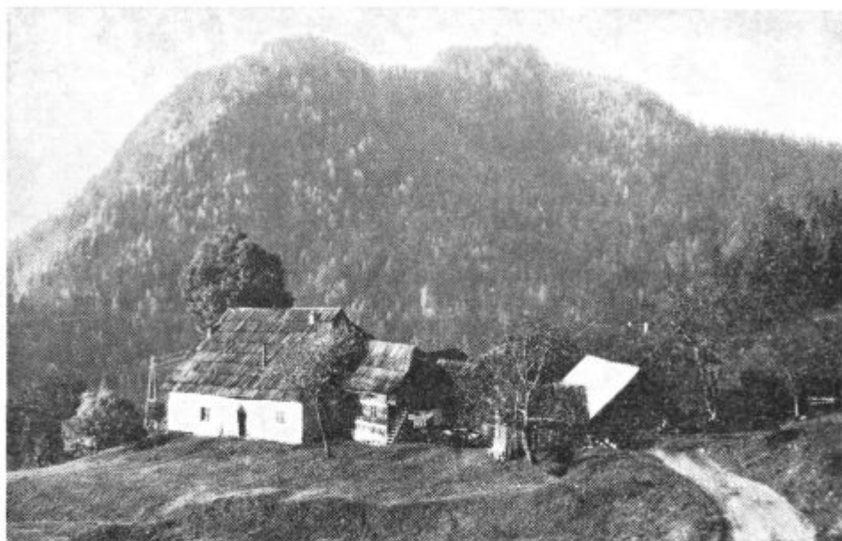
Sl. 1. Verjetno najstarejšo hišo v obravnavani pokrajini izdajajo: črna kuhinja (danes ni več aktivna), lesena streha s čopom, skromen dimnik in majhna okna, ki pa so mlajšega datuma. Hiša stoji na labilnem apneniškem grušču, zato je vsa v razpokah in nevarna za bivanje. Je pred opustitvijo; v bližini je že pod streho nova, kmečkemu ambientu tuja hiša. — Zg. Ušovnik v Podolševi na Solčavskem
