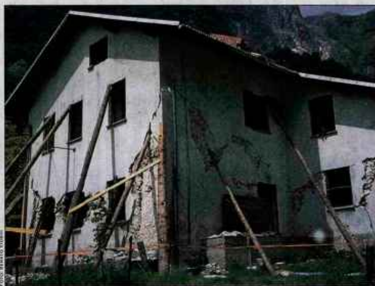
V velikonočnem potresu 12. aprila 1998 poškodovana sirarna na Pologu nad Tolminom
