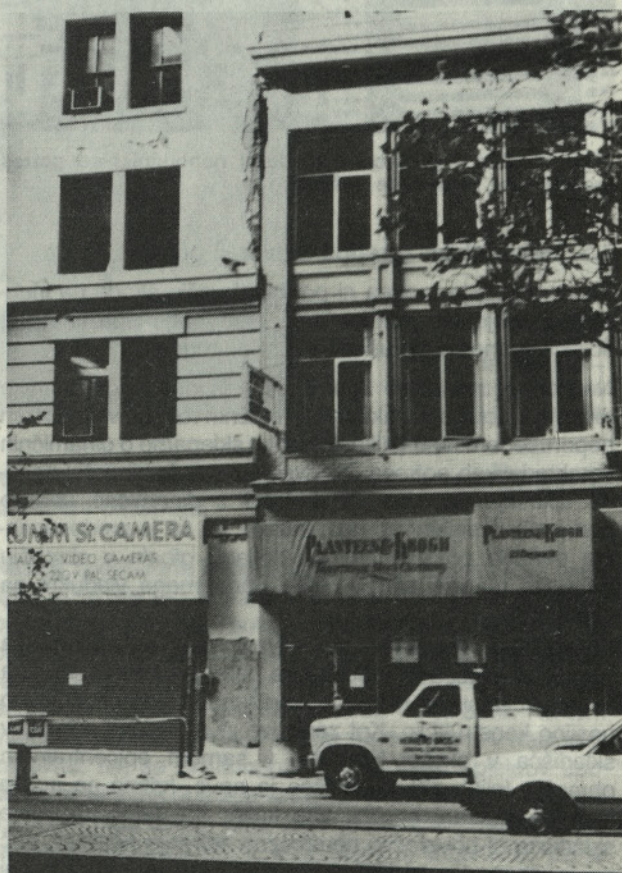
Slika 14: San Francisco – poškodbe na dilataciji, nastale zaradi trkov sosednjih zgradb med potresom
