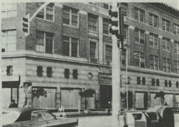
Slika 13: Oakland – opečni polnilni in fasadni zidovi so preprečili porušitev zgradbe z jekleno nosilno konstrukcijo
