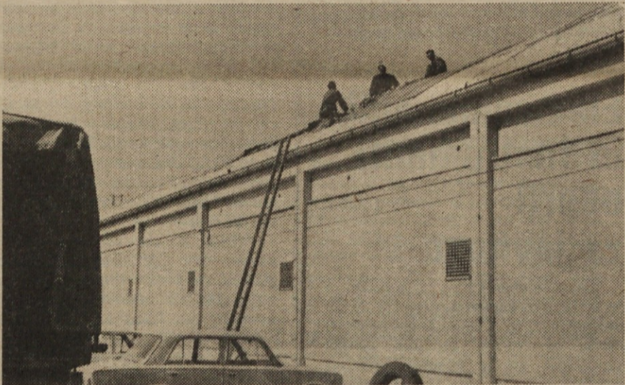
Streho je treba očistiti debelega sloja saj in jo čimprej popraviti. Foto: V.B.R.
