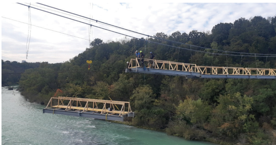
Slika 13. Montaža pohodnih segmentov brvi z nameščeno začasno varovalno ograjo in leseno pohodno ploskvijo.
