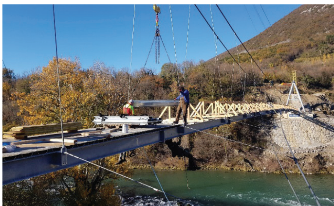
Slika 15. Montaža pohodnih podnic brvi in sočasna odstranitev začasne varnostne ograje in lesenega poda.
