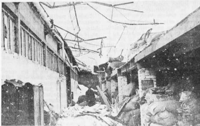
12. marca 1969 — pod težo snega se je zrušila streha skladišča
