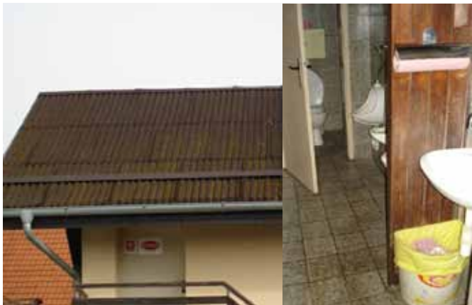
Uničena streha gasilskih garaž ter dotrajane in premajhne sanitarije VGD Sebeborci.
