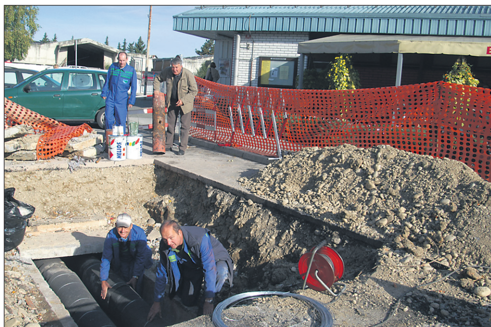
Foto: M. Ozmec Potem ko so večjo okvaro na 200-mm toplovodnem cevovodu ob marketu Rimska peč odpravili, so včeraj popoldne izvedli tudi povezavo s kotlovnico.
