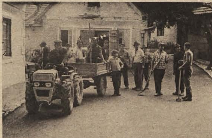
DRAGOMLJA VAS IMA ASFALT – Precej dolgo so občani v Dragomlji vasi zbirali denar, v asfalt pa so ga pretopili in na cesto položili v dobrih dveh dneh. Pri pomembni delovni zmagi je sodelovalo 26 gospodinjstev, ki že na spomlad nameravajo svoje delo nadaljevati. Na sliki: del vaščanov po končani akciji. (Foto: Janez Pezelj)
