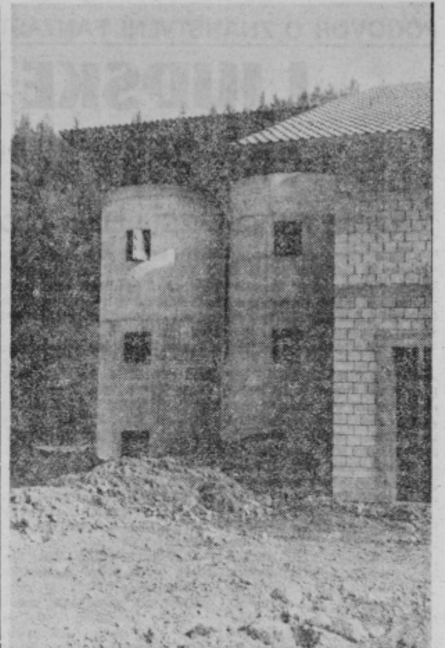
Dva silosa že stojita, tretjega, tik ob novem hlevu, pa še grade.
