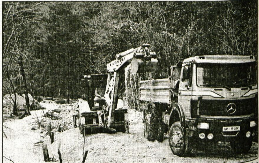
Strugo Belega potoka v Podljubelju so začeli ponovno urejati po novembrskem neurju, nujno pa bo zgraditi oporne zidove pri Tominčevi domačiji.
