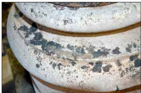
Detajl stebra pred čiščenjem. Lepo vidne obloge, ki so prodrle že globoko v kamenino.
