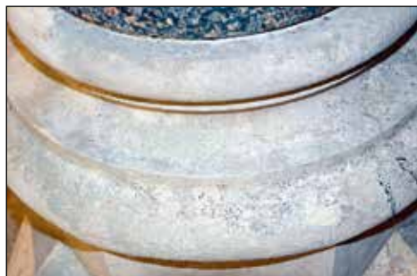
Detajl stebra v fazi čiščenja. Obloge so v večini odstranjene, sledilo je finalno čiščenje in hidrofobna zaščita.
