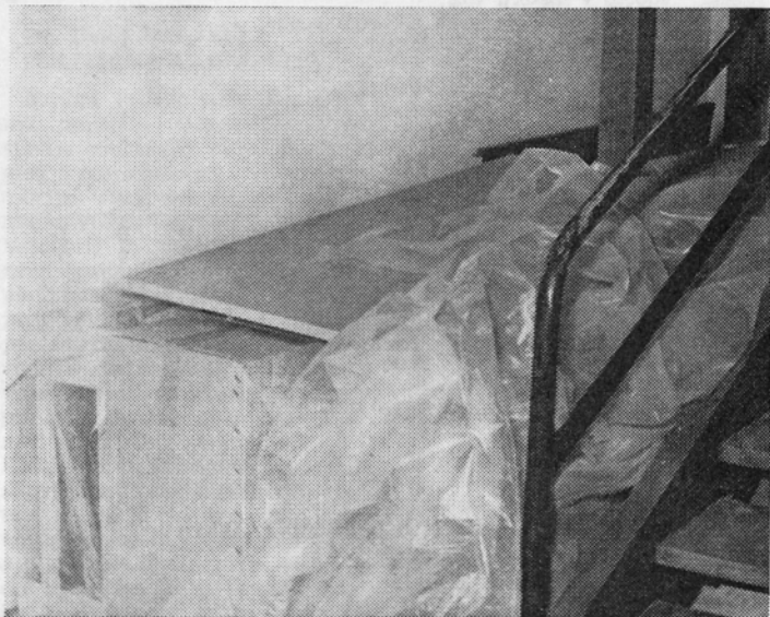
Nova telefonska centrala že dalj časa sameva pod stopnicami v upravnem posloplju. Končno je le prišlo do adaptacije prostorov, kjer bo centrala montirana, tako da bo pričela funkcionirati, vsaj upamo lahko, še v letošnjem prvem polletju.
