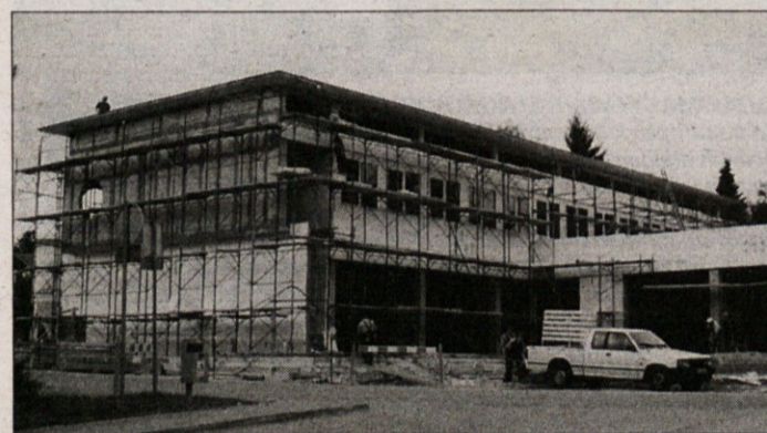
GRADNJA SE ZAKLJUČUJE - Nov trgovsko-poslovni center, ki ga ob Zadružni cesti gradi črnomaljski Beograd, že dobiva končno podobo. V nekaj mesecih bodo v njem že odprli vrata prvi lokali, še vedno pa je naprodaj 30 odst. prostorov. (Foto: M. B.-J.)
