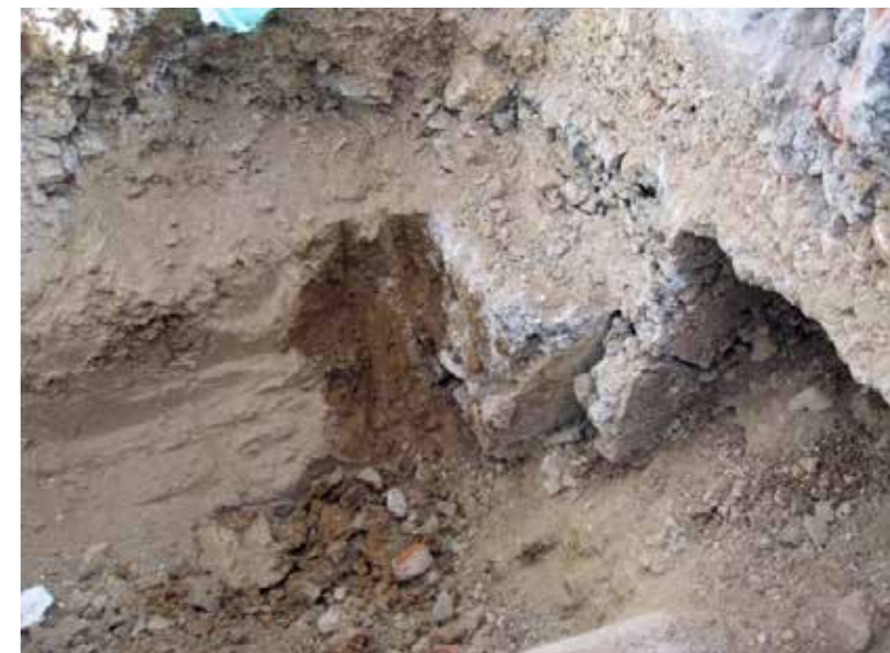
Slika 3: Temelj, izveden na kontaktu med glinenimi plastmi in kamnino. Figura 3: La fondazione effettuata al contatto tra gli strati di argilla e roccia.
