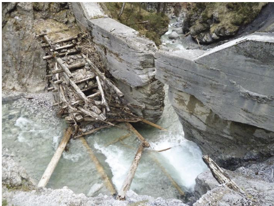
Slika 6 • Ali bi sami svoj osebni avtomobil vzdrževali tako slabo? Pregrada na hudourniku Belca v »primernem« stanju. (Foto: Manica Martinčič, 2012)
