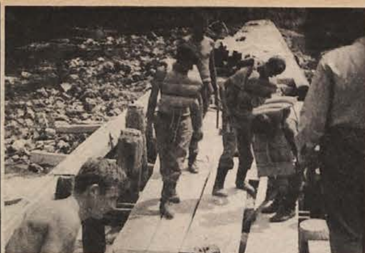
Novomeški jez pri Seidlovem mlinu je že skoraj dograjen. Z marljivim delom je delavcem in vojakom uspelo zabetonirati oba kraka jez, tako da je ostal za zajezitev le ozek pas v sredini. Delo je nevarno, zato so graditelji zavarovani z rešilnimi pasovi. (Foto: Markelj)
