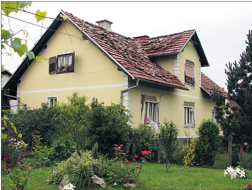
Poškodbe zaradi eksplozije so vidne na celotni hiši Bolcarjevih.
