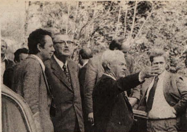
ZA OBČINSKI PRAZNIK PO ASFALTU – Pokrovitelj Franc Leskošek-Luka si je 10. oktobra s predstavniki črnomaljske in novomeške občine ogledal gradbišče partizanske magistrale od Podljudna do Semiča. Slovesna otvoritev bo predvidoma 29. oktobra. (Foto: J. Pavlin)
