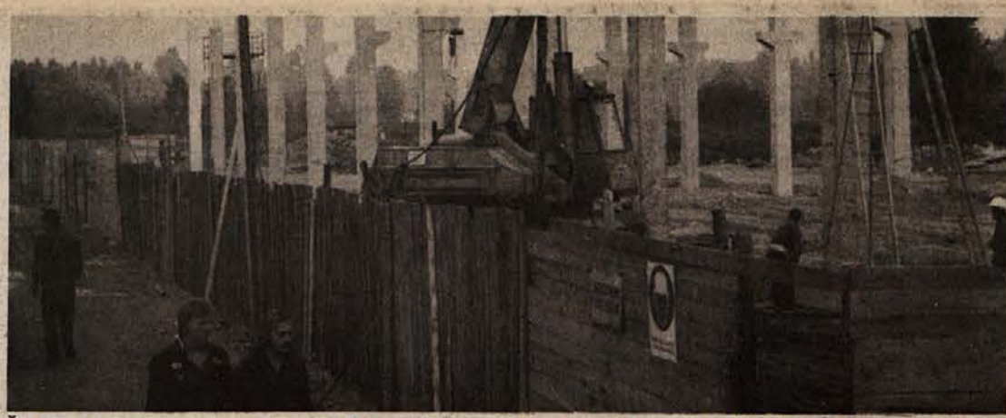
ŠE ENA PROIZVODNA DVORANA – RIKO Ribnica – tozd RIKO STROJ gradi v Ribnici še eno proizvodno dvorano, ki bo letos dokončana. Prihodnje leto bodo zgradili proizvodno dvorano še v Loškem potoku. (Foto: J. Primc)
