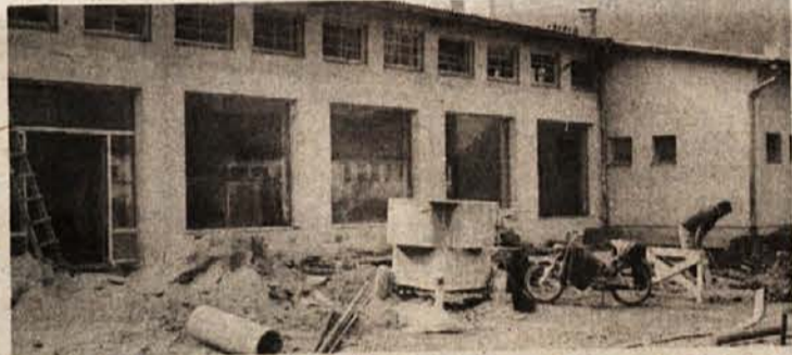
VEČJI MERCATOR — Nekdanji „Cekinček“, nazadnje skladišče Dane, ki se ga je le-ta zaradi odročnosti odkrižala, spreminja podobo. Večja okna naj bi dala objektu bolj trgovski videz. Vsekakor bo Mercator vsaj na Mirni za nekaj časa prehitel konkurenco.
