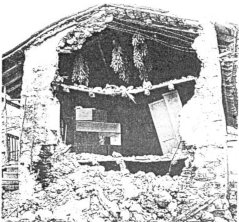
RUŠEVINE ZGRADBE V BREGINJU, UNIČENE V POTRESU 6. 5. 1976
