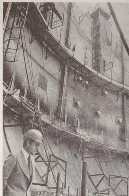
Na gradbišču jedrske elektrarne v Krškem. Tu bo stal reaktor (Foto: Sveto Busić)
