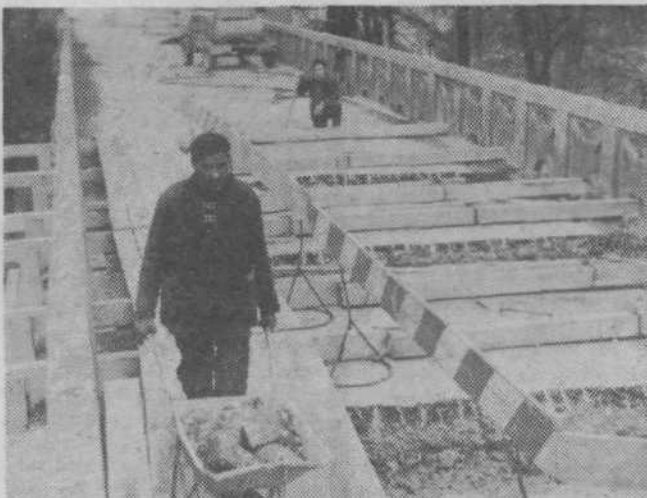
Delo na fužinskem mostu vidno napreduje. Sedaj pripravljajo temelje za položitev prečnih nosilcev, na katere bodo pritrčili cevi za odpadne vode z desnega na levi breg Ljubljane. (Besedilo in slika: Ciril Zupancič)
