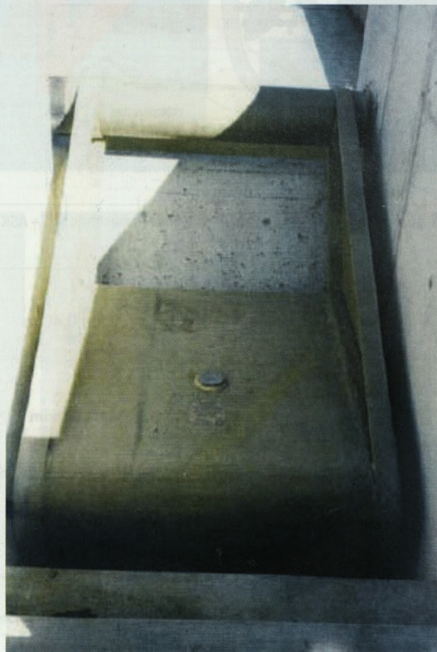
Slika 8 • Pogled v prostor s plavačem avtomatske HST – ASK lopute
