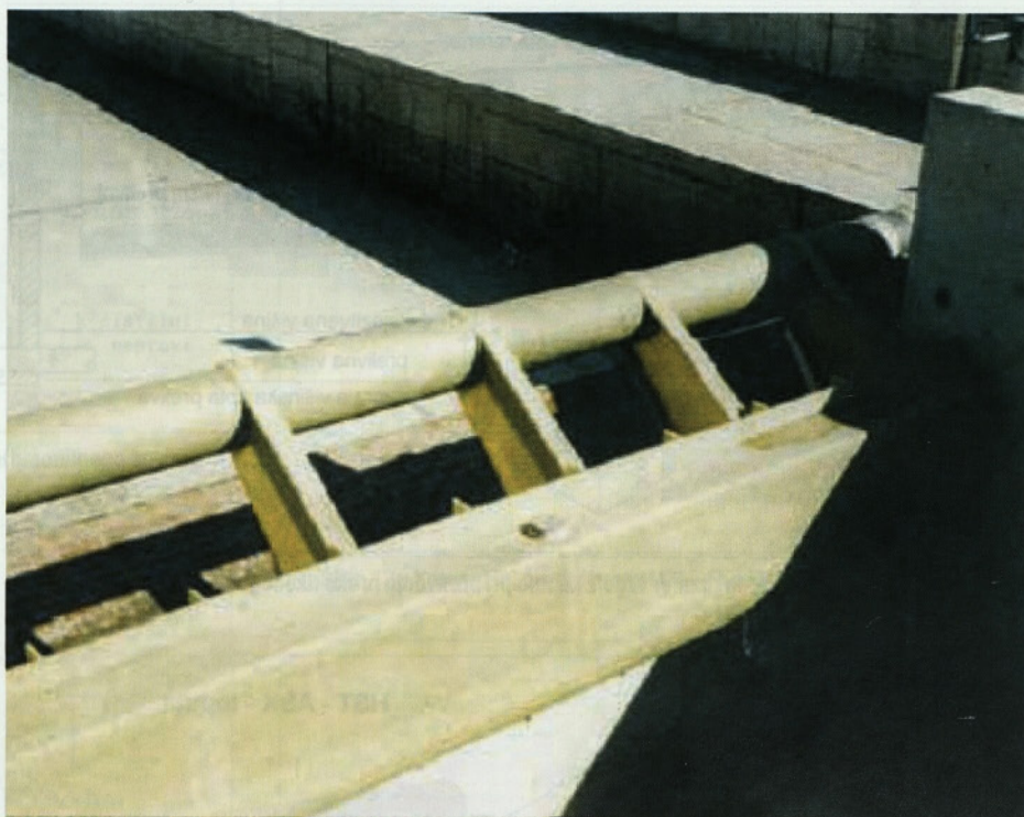
Slika 7 • Pogled na avtomatsko HST - ASK loputo z zunanje, odtočne strani razbremenilnika
