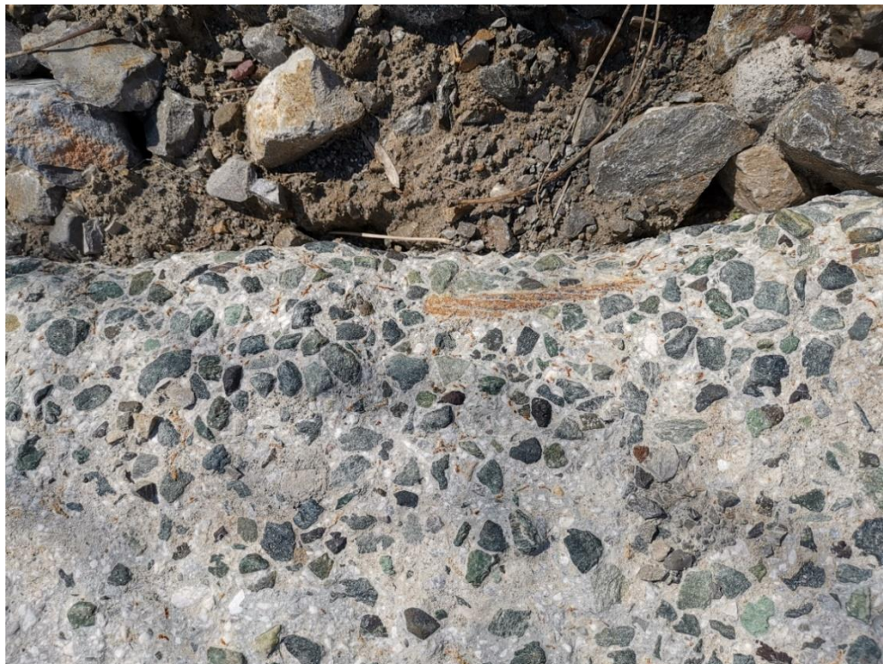
Slika 15: Poškodbe spodnjega dela PŽP-MAB do kabla.
