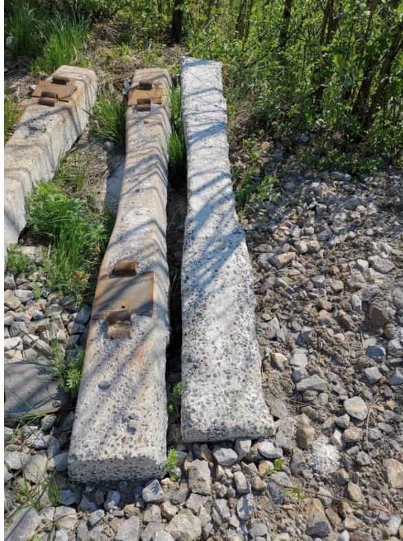
Slika 14: Na spodnjem delu abrazivsko in mehansko poškodovani PŽP-MAB..
