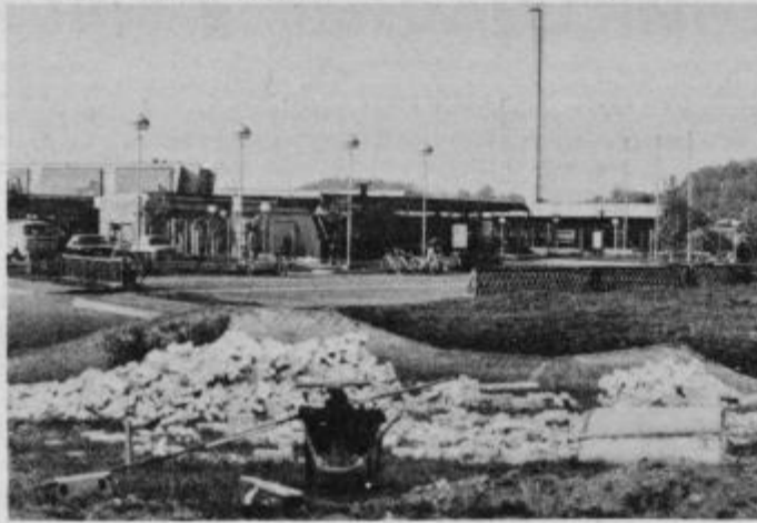
Za položitev temeljnega kamna za hotel pri Ptujskih toplicah je že vse pripravljeno.
