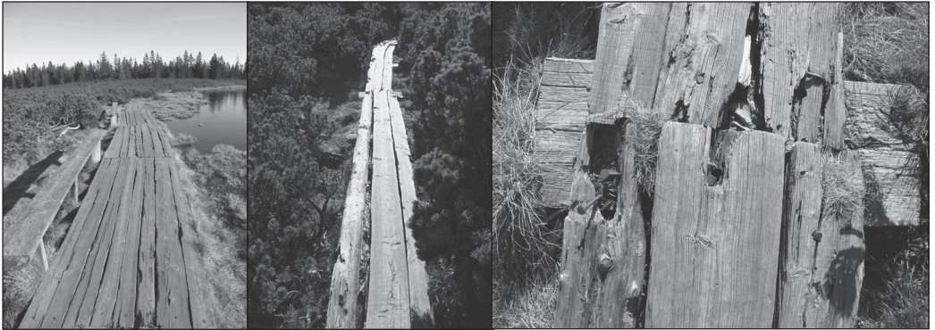
Slika 4: Dotrajana in nevdrževana infrastruktura na območju Ribniškega jezera
