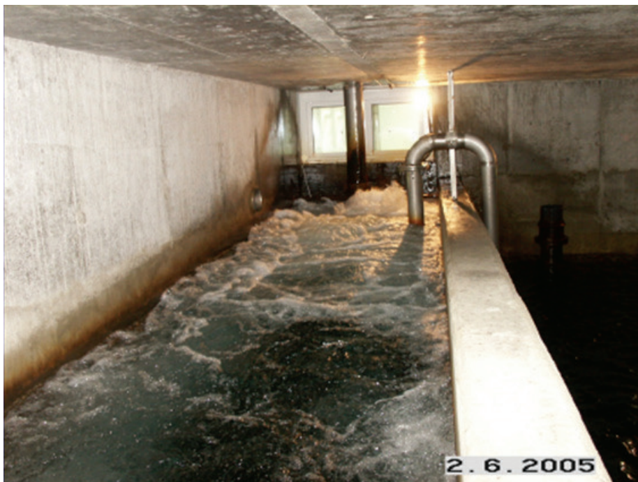
Slika 26 • Ozračevanje črpane podtalnice z injektorjem za načrtovano oksidacijo Fe in Mn v vodonosniku.
