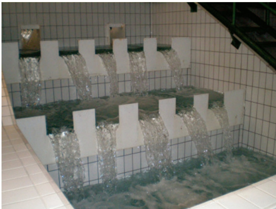
Slika 24 • Ozračenje obrežnega filtrata na čistilni napravi pred infiltracijo v vodonosnik.
