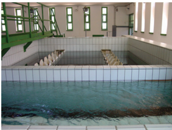
Slika 20 • Na lamelnem usedalniku peska očiščeni obrežni filtrat.
