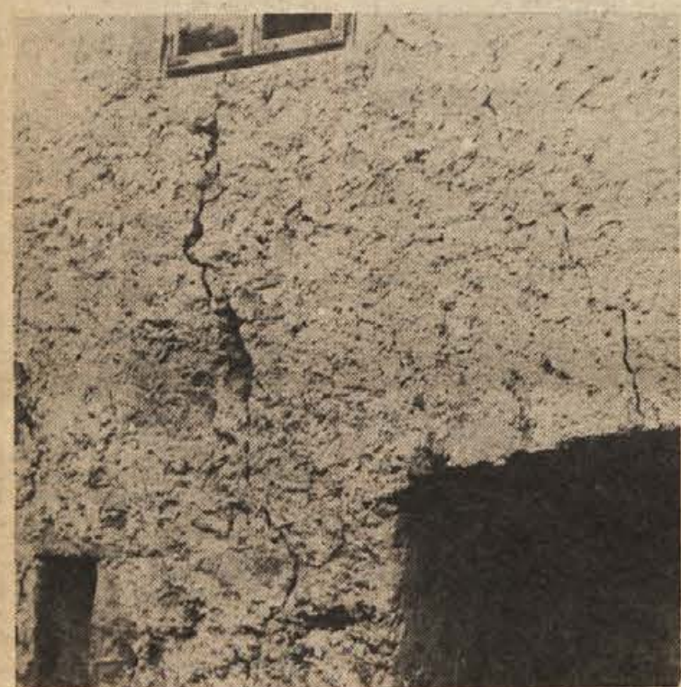
Drseča zemlja v Podplanini je povzročila pokanje zidov na nekaterih hišah (glej sliko), odnesla pa je tudi že del vaške poti – (Foto: Primc)
