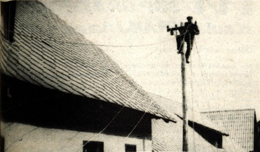
Poljčica pri Gorjah Delavci Elektro podjetja iz Žirovnice, enote Bleda so februarja in marca obnovili vse elektrovođe. Nekateri delavci so obnovili še glavni vod do samih stanovanjskih hiš in bo vsaj dovod elektrike po tej vasi brez večjih zastojev. Vodi so novi in močnejši. — Foto: J. Ambrožič
