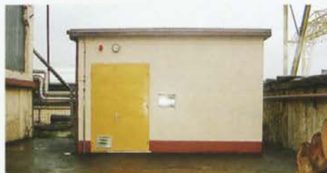
Kemična čistilna naprava za tehnološko odpadno vodo v PC Vezan les
