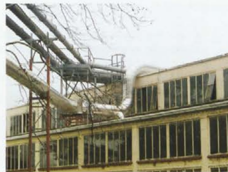
Novi parovod, ki povezuje Toplarno in ostale porabnike v Straži
