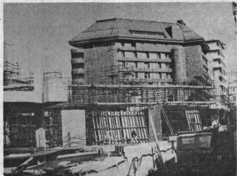
Gradbišče na Kraigherjevi ploščadi med Metaliko, Holiday Innom in Šestico je spet oživele. Gradbinci iz Gradisa postavljajo mogočen stanovanjsko-poslovno-trgovski objekt, ki bo po obsegu tak kot sosednja Metalika. Zgrajen mora biti do konca prihodnjega leta. Poleg številnih manjših lokalov bo tudi imel specializirane prodajalne čevljev, blagovni hiši Tkanine in Modne hiše, poslovne prostore Gradisa in Stanovanjsko-komunalne banke. Financira ga 36 investitorjev.
