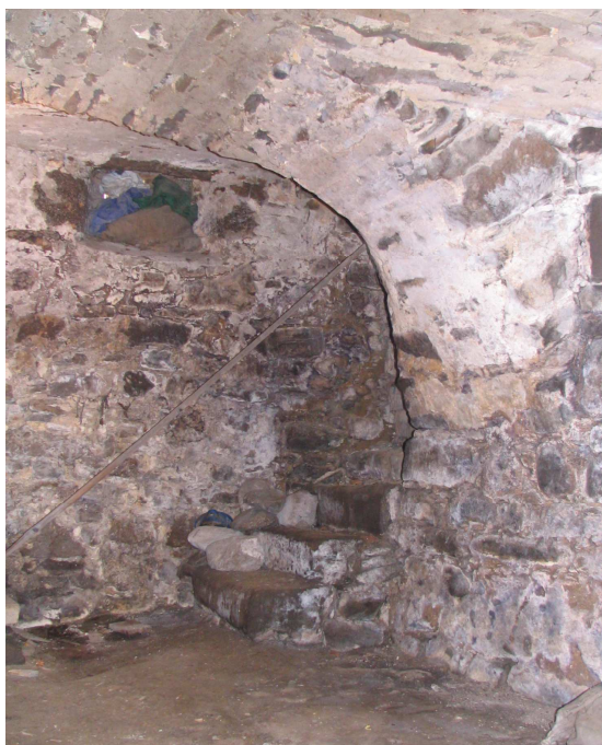
Slika 160: Najstarejši del kleti – severni del vzhodnega dela zgradbe, polkrožno obokan, s kamnitimi stopnicami v kuhinjo.
