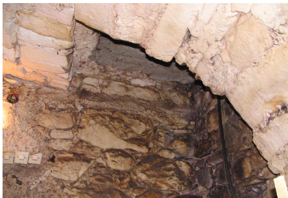
Slika 188: Zazidana stropna odprtina za nekdanji prehod iz veže v nadstropju v klet, Šuštarjava hiša.
