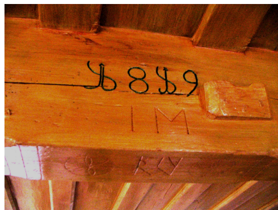
Slika 60: Stropni tram z okrasjem iz 1819. leta, inicialkami lastnika, Marijinim znamenjem in svaricami levo in desno v hiši na Hribce, Črni Potok.
