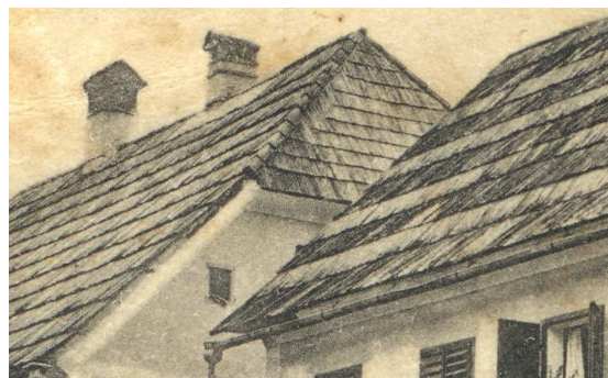
Slika 68: Leva streha Palčave hiše je prekrita s strešno desko s prekritimio žebli, desna Šučava pa s tanjšo, razcefrano šindro; okoli 1900, Plešče.
