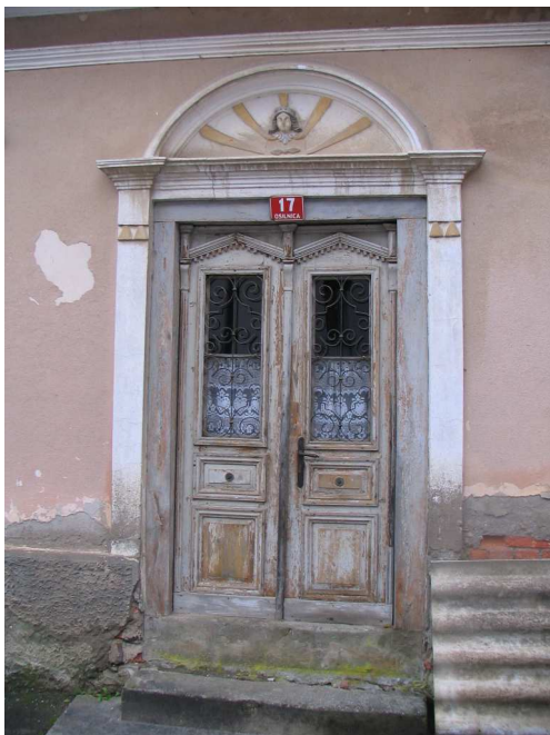
Slika 113: Vhod v Kvaternikovo hišo s trgovino in gostilno, postavljeno v začetku 20. stoletja, Osilnica.
