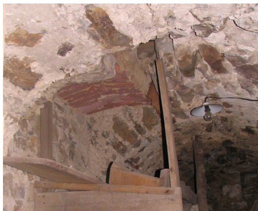
Slika 230: Mala, z opekami zazidana odprtina za dostop z lestvijo v klet iz nekdanje veže.
