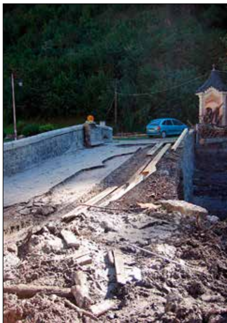
Poškodovan most Na klovžah. Foto: Damjana Pediček Terseglav, 2007
