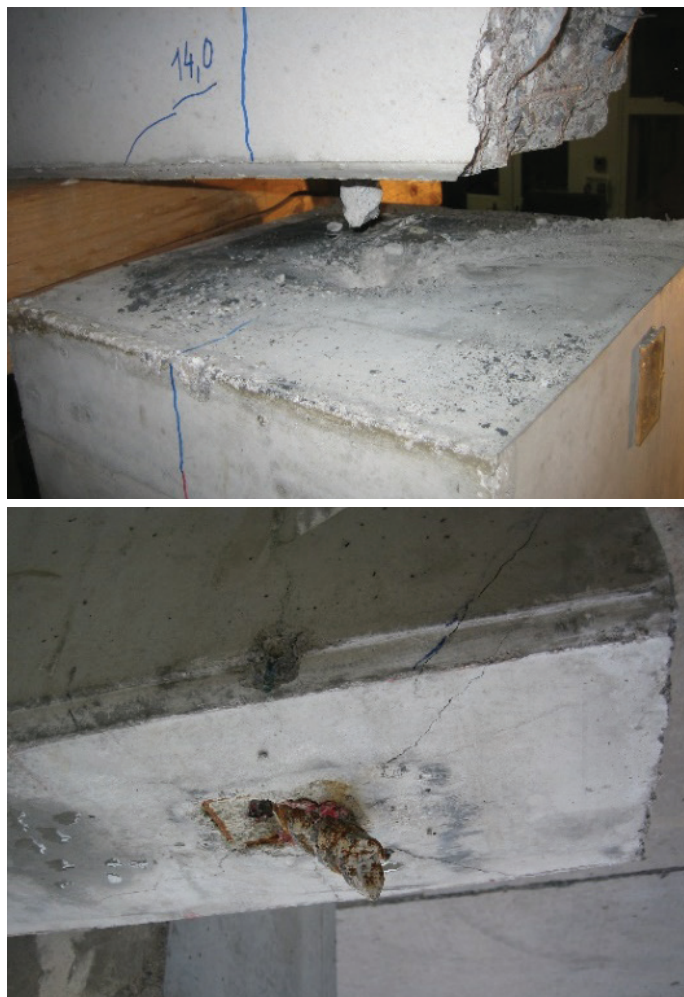
Slika 3. Lokalne poškodbe in lokalna porušitev mozničnega stika.
