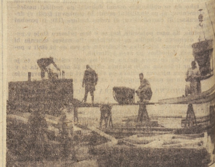
Največ nesreč pri delu so v celjski občini zaznamovali v gradbeništvu, zlasti na manjših gradbiščih, kjer delo razporejajo in vodijo strokovno premalo usposobljeni ljudje. V šestih mesecih letošnjih dni (povprečno število zaposlenih v vseh gradbenih podjetjih na območju občine pa je 2325 delavcev)
