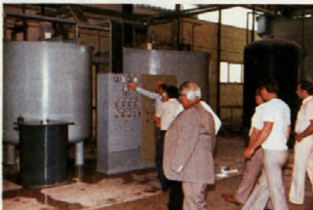
Zagon avtomatizirane naprave za čiščenje odpadnih voda
