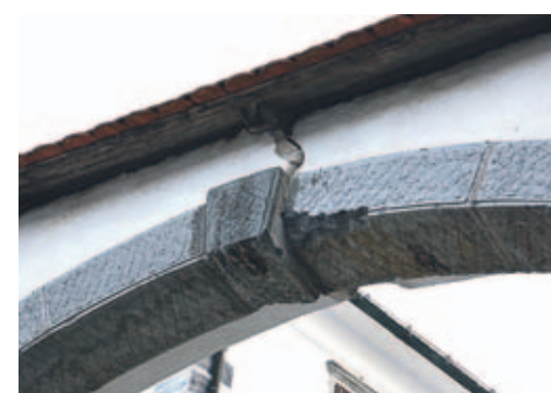
Najvišji del oboka se je ob udarcu odkrušil in močno zanihal – stena se je premaknila in počila na treh koncih.
