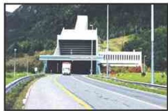
Začela se je prenova vozišča v predoru Karavanke, ki bo potekala tudi na avstrijski strani.
