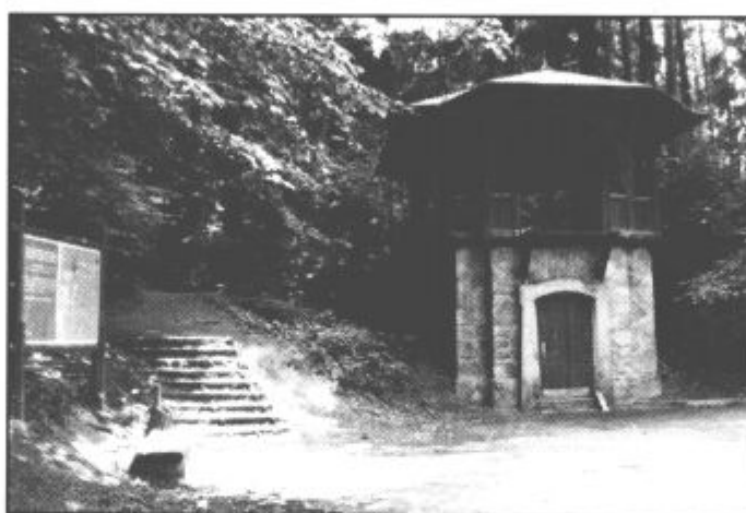
Razpadajoč objekt zraven čudovite vile Herberstein gotovo ne spada. Potreben je takojšnje obnove!
